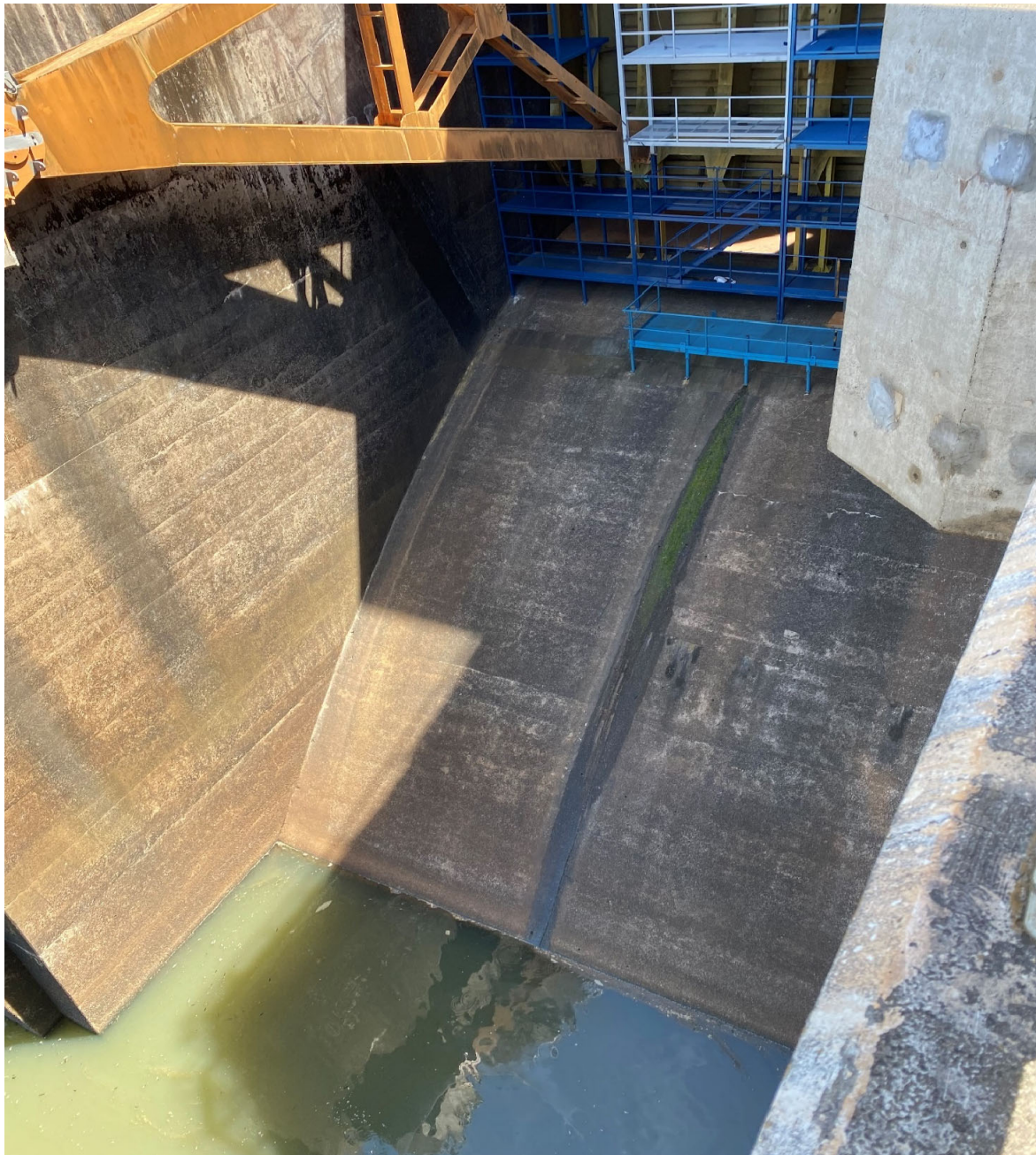
Figura 51 - Vista parcial de la rápida (creager) correspondiente a la Compuerta # 19
