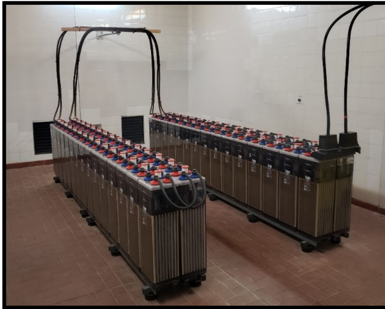
Figura 9. Banco de baterías actual
