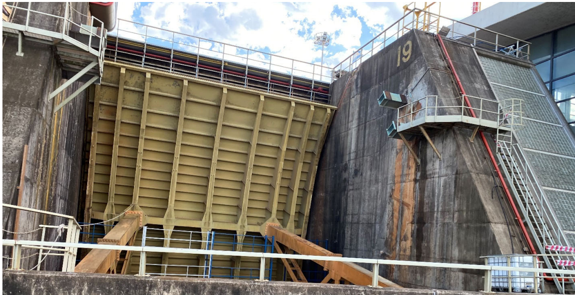
Figura 54 - Compuerta # 19 sin su sistema de izaje
