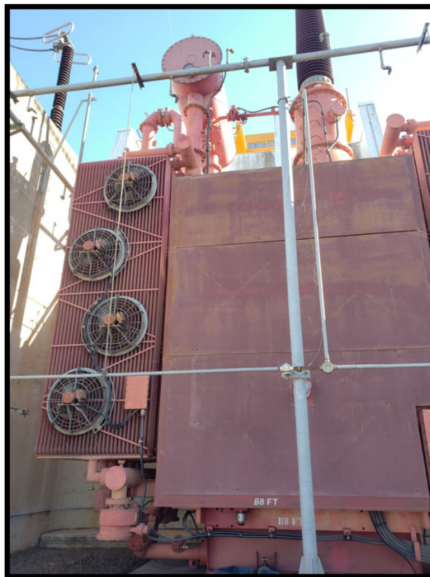
Figura 10. Transformador actual de la central
