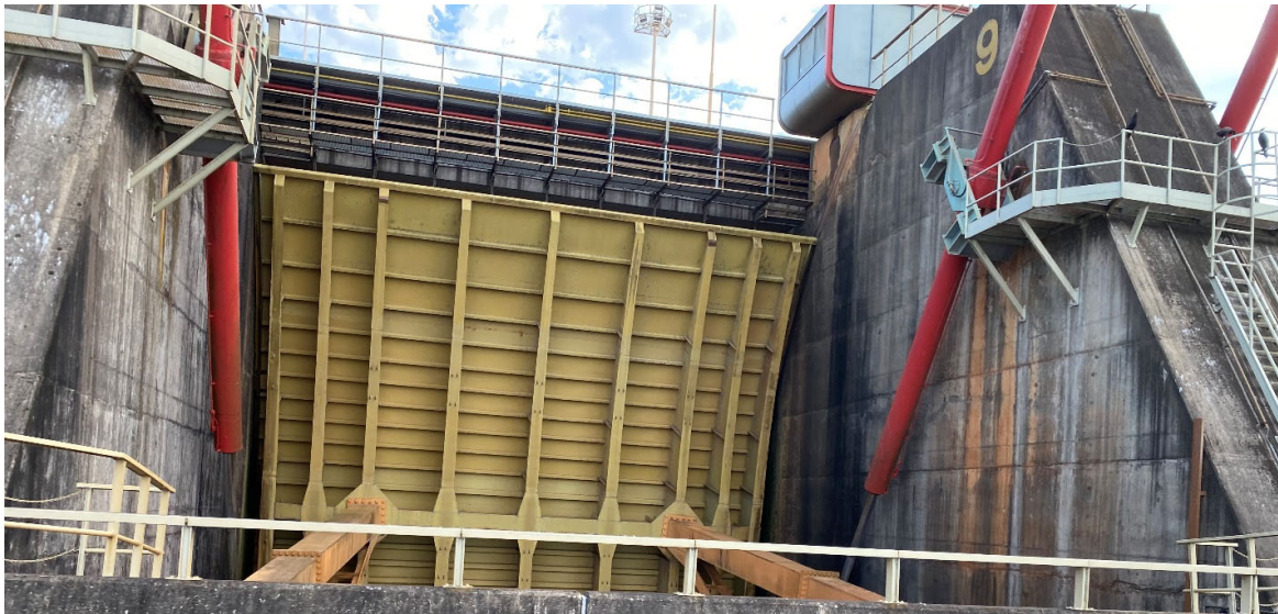
Figura 55 - Compuerta # 9 con su sistema de izaje
