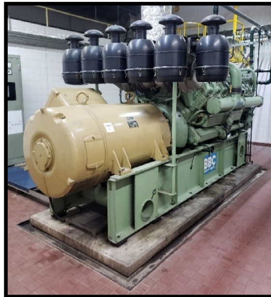
Figura 8. Generador de emergencia actual.
