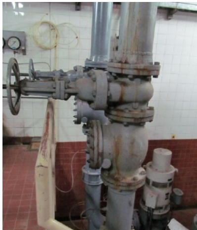
Figura 5 – Descarga de bomba de drenajes
